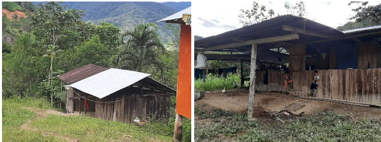
Fotos 48. Edificaciones en estado malo
